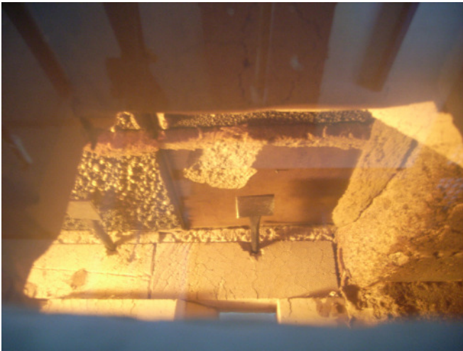
Bild 3: 13. Minute/F1, Betonabplatzungen an unbeschichteter Teilfläche
